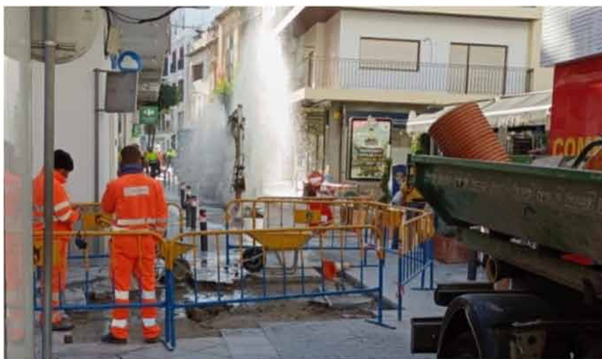
Momento en el que revienta la tubería, con los operarios trabajando. / Á.C.G.
