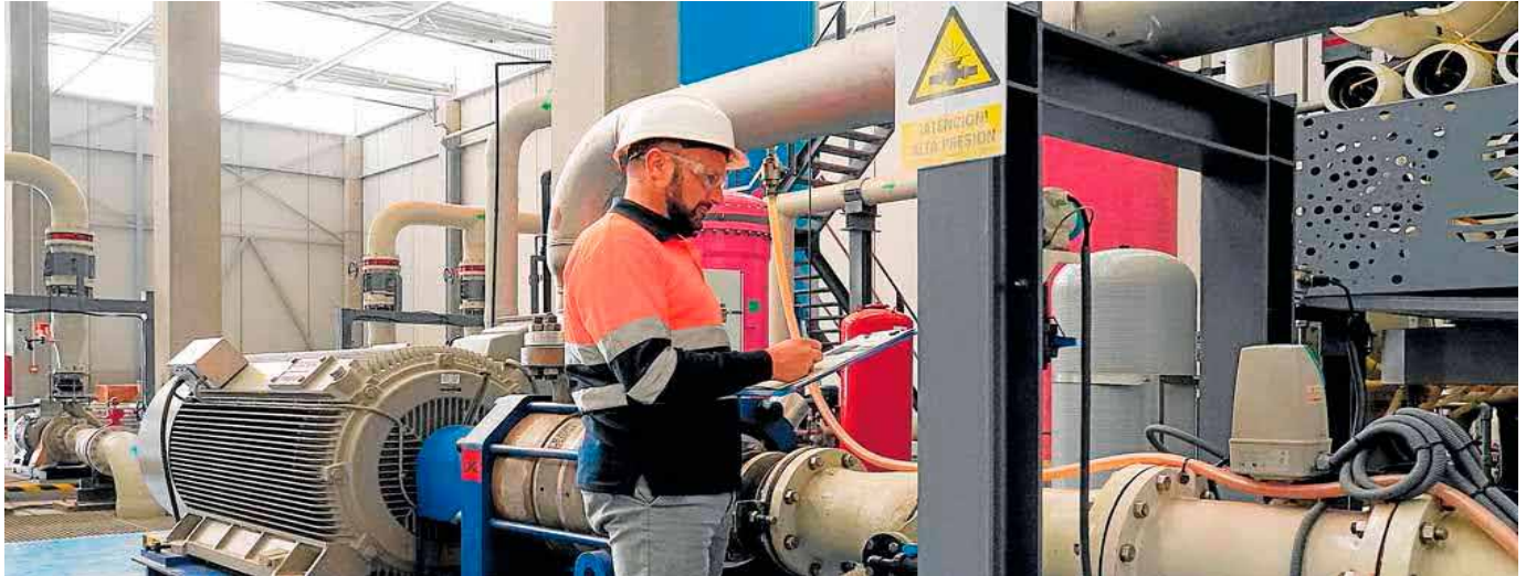
Imagen de archivo de un operario en una planta de desalación de agua de mar. SUR
